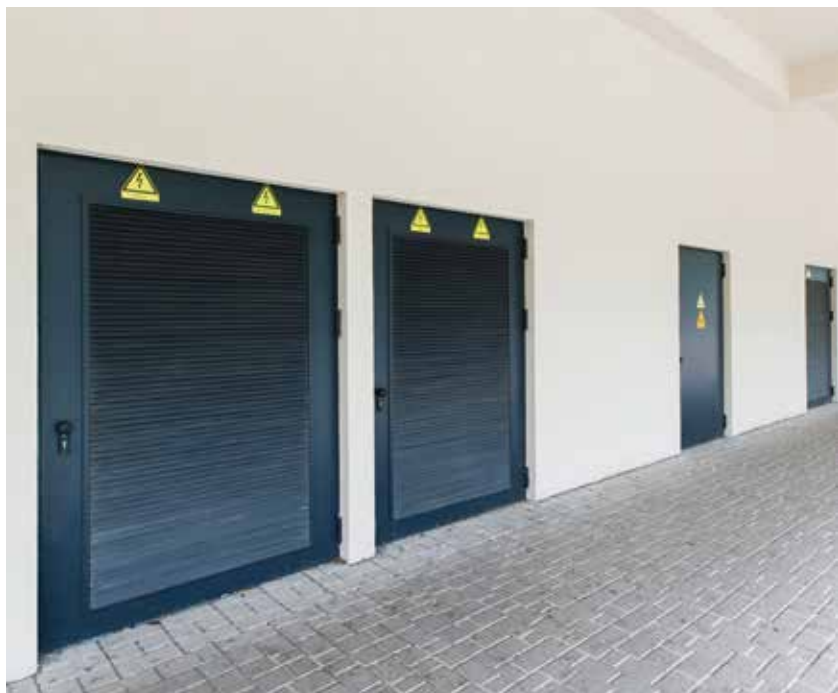
Mehrzwecktür mit Trafogitter
